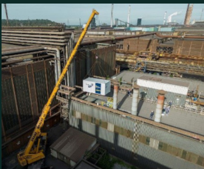
thyssenkrupp steel europe AG Stromerzeugung aus Abwärme
